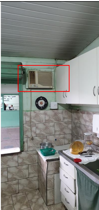
Foto 30: Escola Victória Cerutti Petters. Ar condicionado sem funcionar
