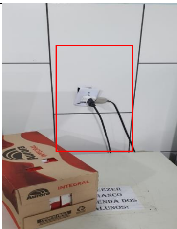
Foto 11: Escola Professor Wadislau Schmidt. Tomada ligada com rachaduras
