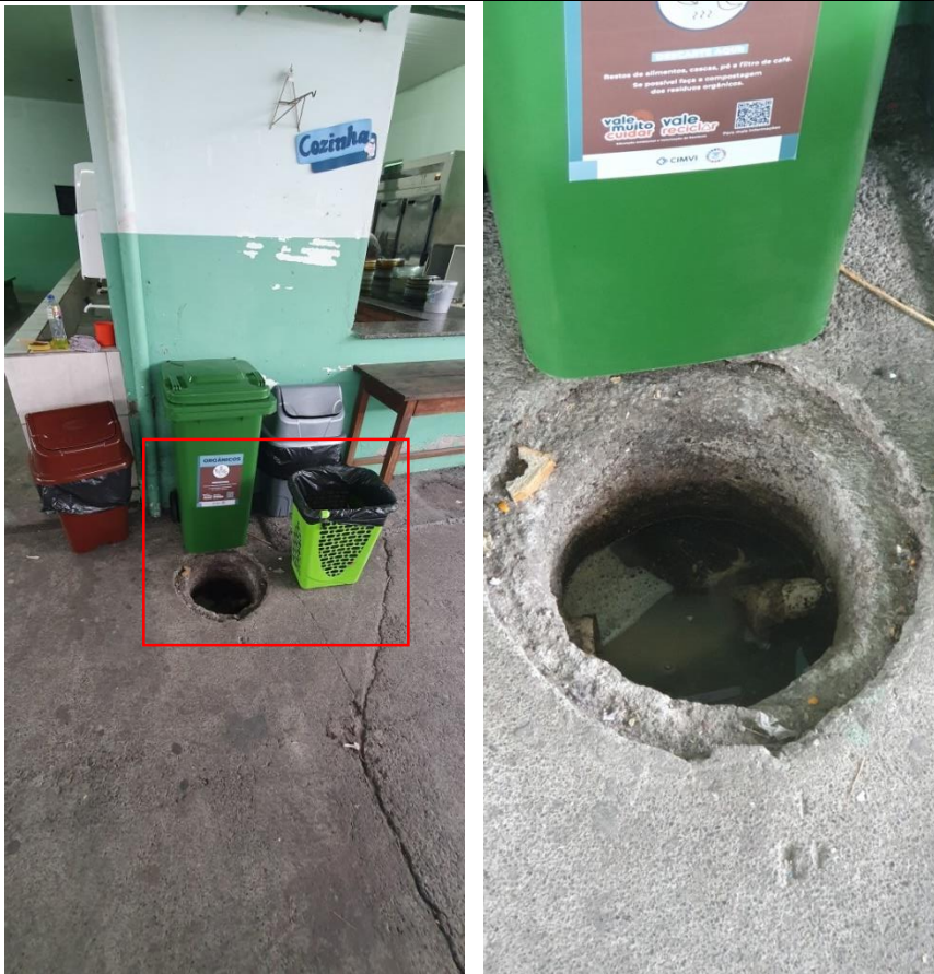
Foto 18 e 19: Escola Victória Cerutti Petters. Caixa de gordura sem acabamento apropriado
