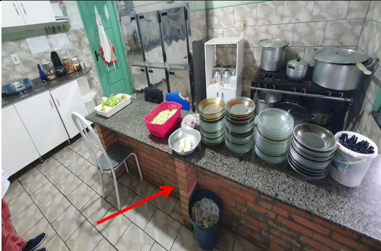
Foto 16: Escola Victória Cerutti Petters. Bancada sem revestimento
