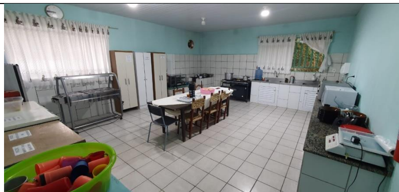
Foto 12: Escola Professor Wadislau Schmidt. Falta de revestimento em toda a parede
