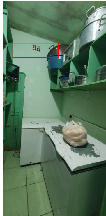
Foto 25: Escola Victória Cerutti Petters. Abertura no almoxarifado
