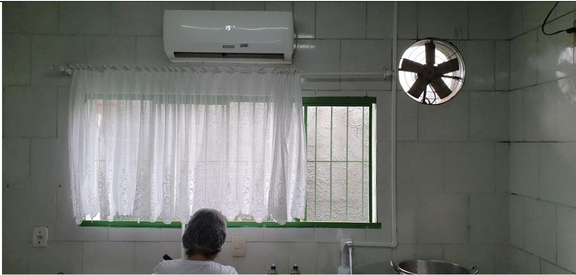
Foto 27: CEI Caroline do Nascimento. Janela da cozinha e exaustor sem telas
