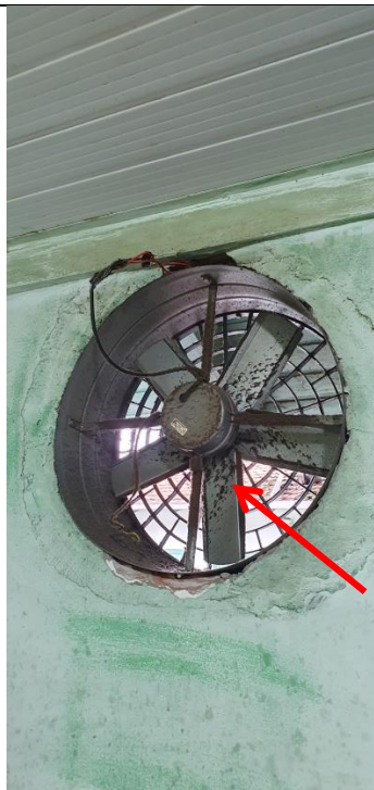
Foto 31: Escola Victória Cerutti Petters. Sistema de exaustão sem funcionar com fios aparentes
