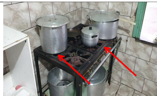
Foto 05: Escola Victória Cerutti Petters. Fogão com problemas no registro e panelas sem cabo ou alça
