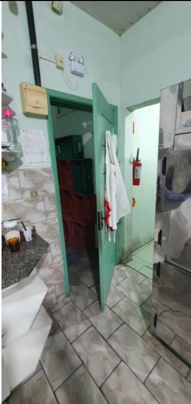
Foto 26: Escola Victória Cerutti Petters. Porta sem fechamento automático
