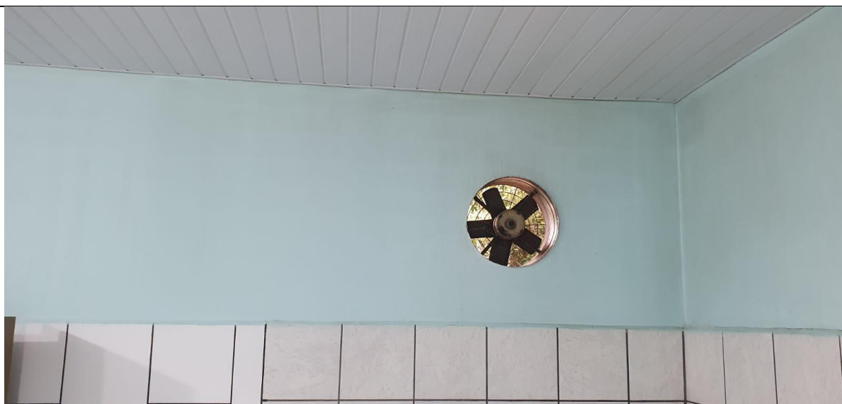
Foto 32: Escola Professor Wadislau Schmidt. Sistema de exaustão sem funcionar.
